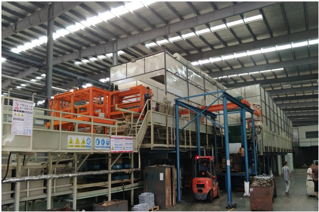
滚镀锌生产线侧集气罩及顶吸
