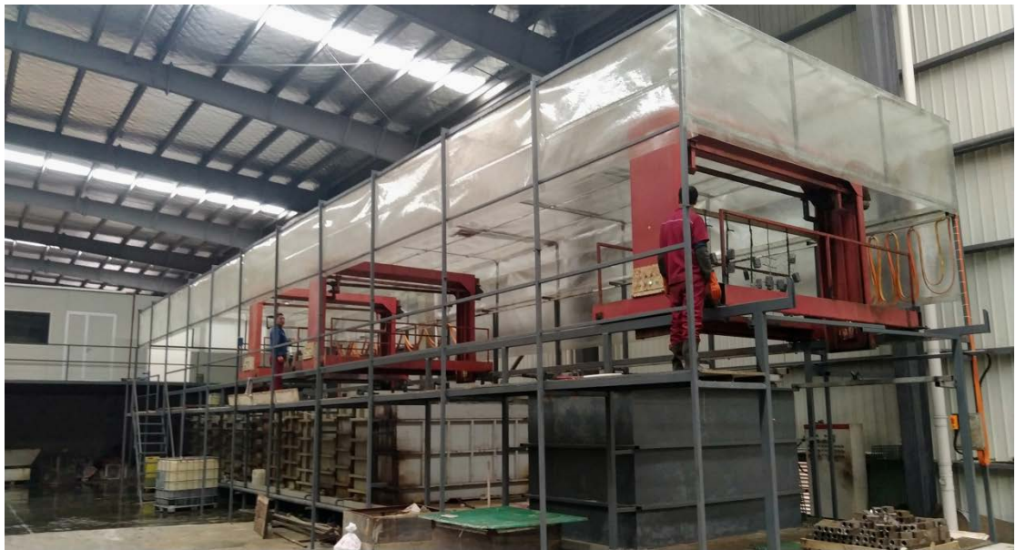
滚镀锌生产线侧集气罩及顶吸
