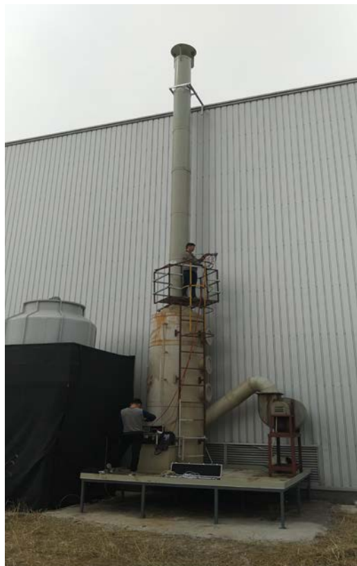
碱液喷淋塔（挂镀线）
