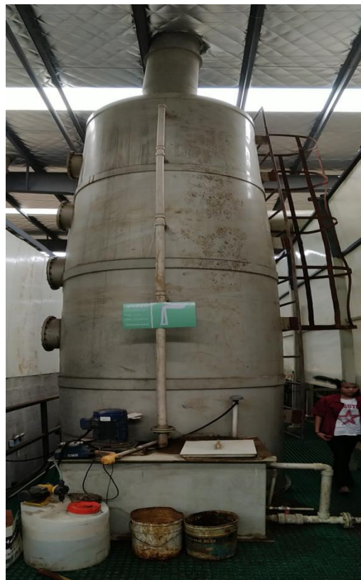
碱液喷淋塔（滚镀线）
